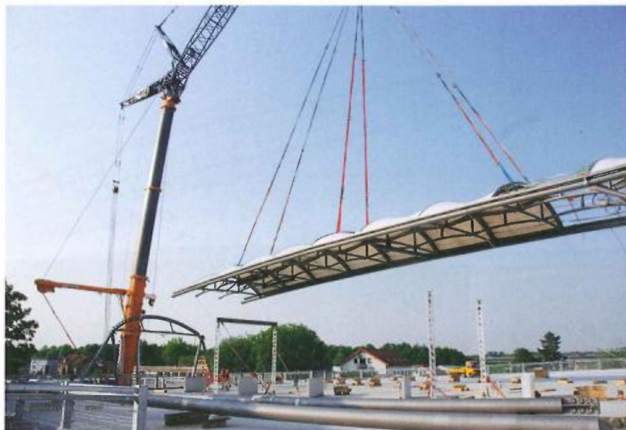
Das 50 m lange und 40 t schwere erste Teilstück des Membrandaches wurde auf die vorgesehene Höhe gehoben.
